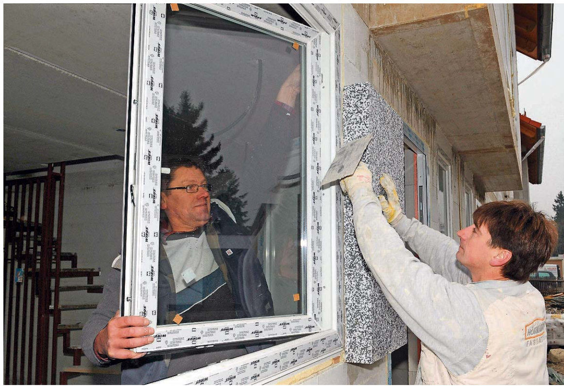
Die energetische Sanierung von Fenstern lohnt sich in vielen Fällen.
